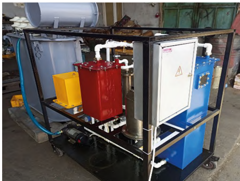
"Zartransformator" MChJ korxonasida ishlatilib bo'lgan transformator moylarini tozalash jarayonlari
